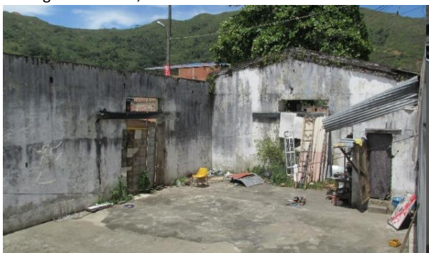
Figura 5: Estado antes de las obras de restauración de la bodega del conjunto férreo de Suarez. Imagen del Autor. Año 2015.
